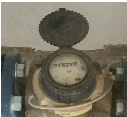
Contador del pozo de Aras
