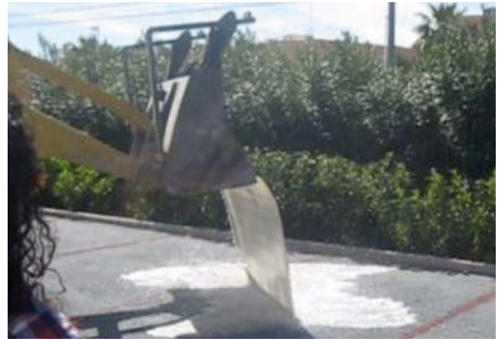
Aparcamiento con pavimento permeable en la piscina cubierta (Benaguasil, Valencia)
